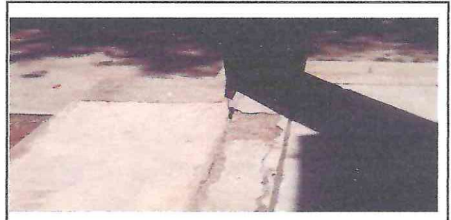
Foto 6: La estructura presenta grietas.
